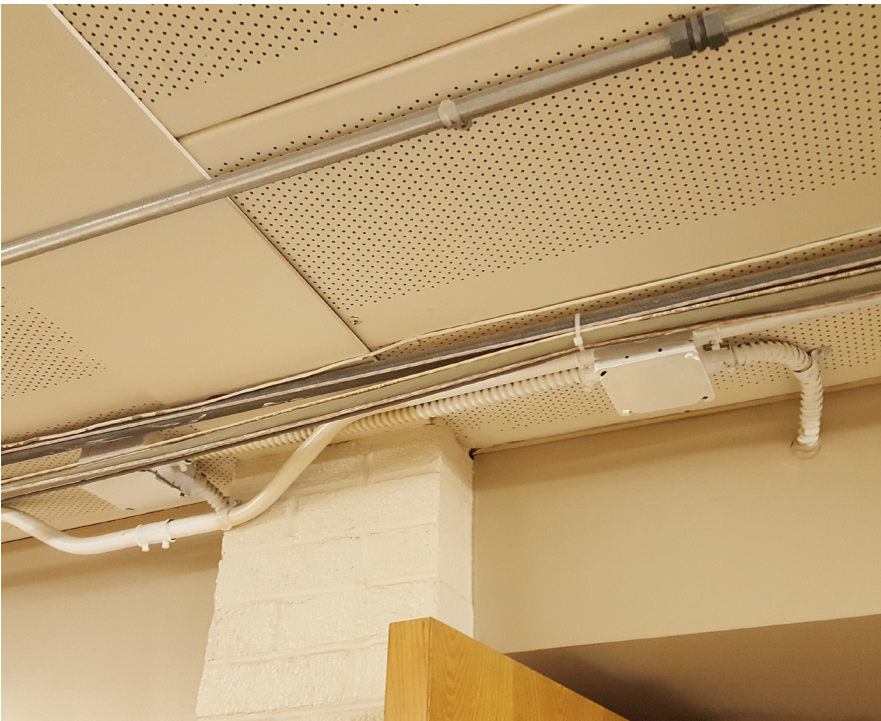
Hallway ceiling exposed conduits
